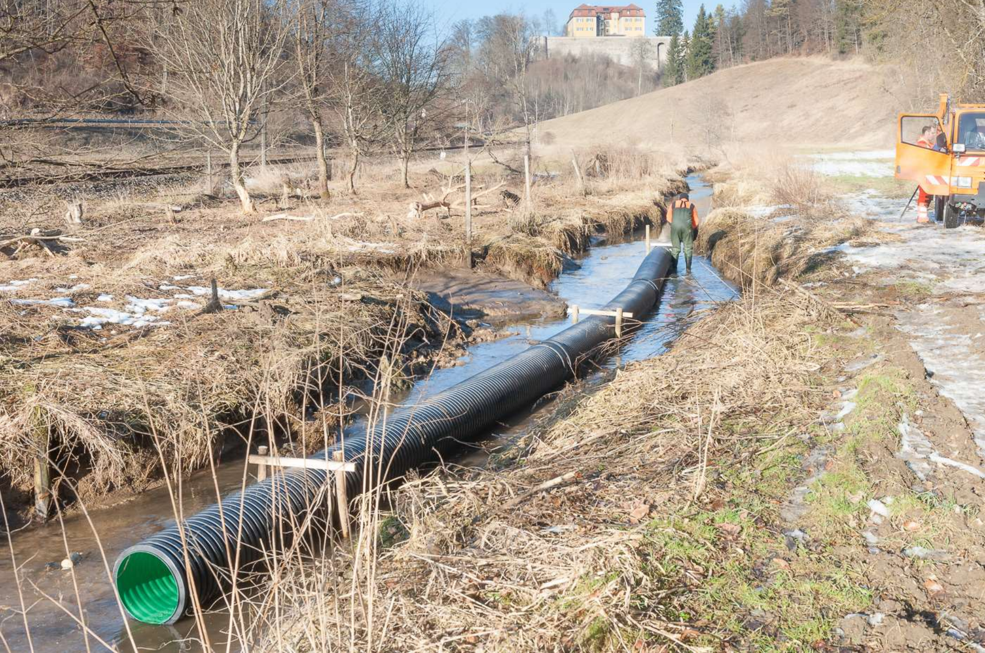
Modul Vollsickerrohr auf Grund neben einer Bahnlinie
